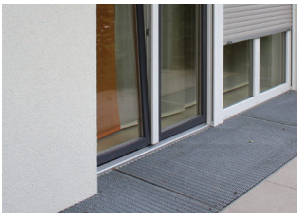
109 Großzügige Gitterroste schützen die Innenräume vor eindringendem Wasser; Modellprojekt „WAL“, WBG Nürnberg
