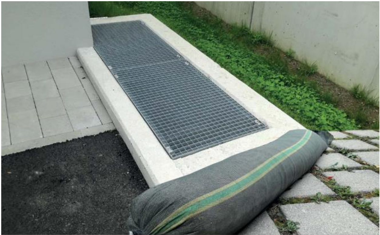
Abbildung: Kellerfenster mit erhöhtem Lichtschacht zusätzlich durch Sandsack vor Wassereintritt geschützt
